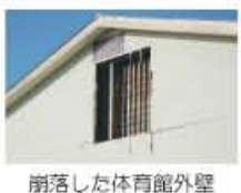
崩落した体育館外壁
